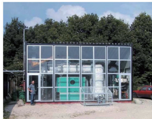
図11 バイキング炉のフローと写真 8)
